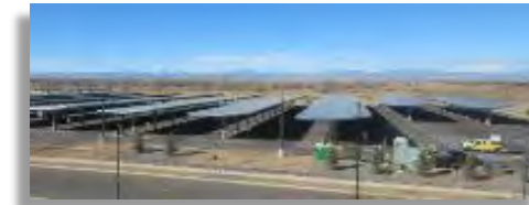
1.6MW Solar Canopy
